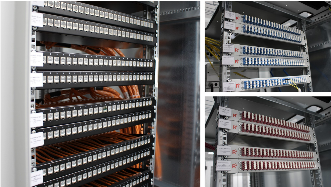
Blick ins neue Colocation Rechenzentrum
