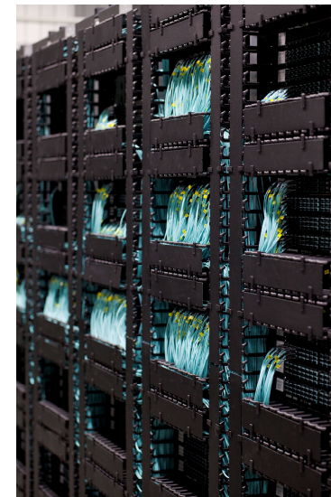
Rosenberger OSI Cable Management System im Rechenzentrum Patchverteiler und Geräte-Rack
