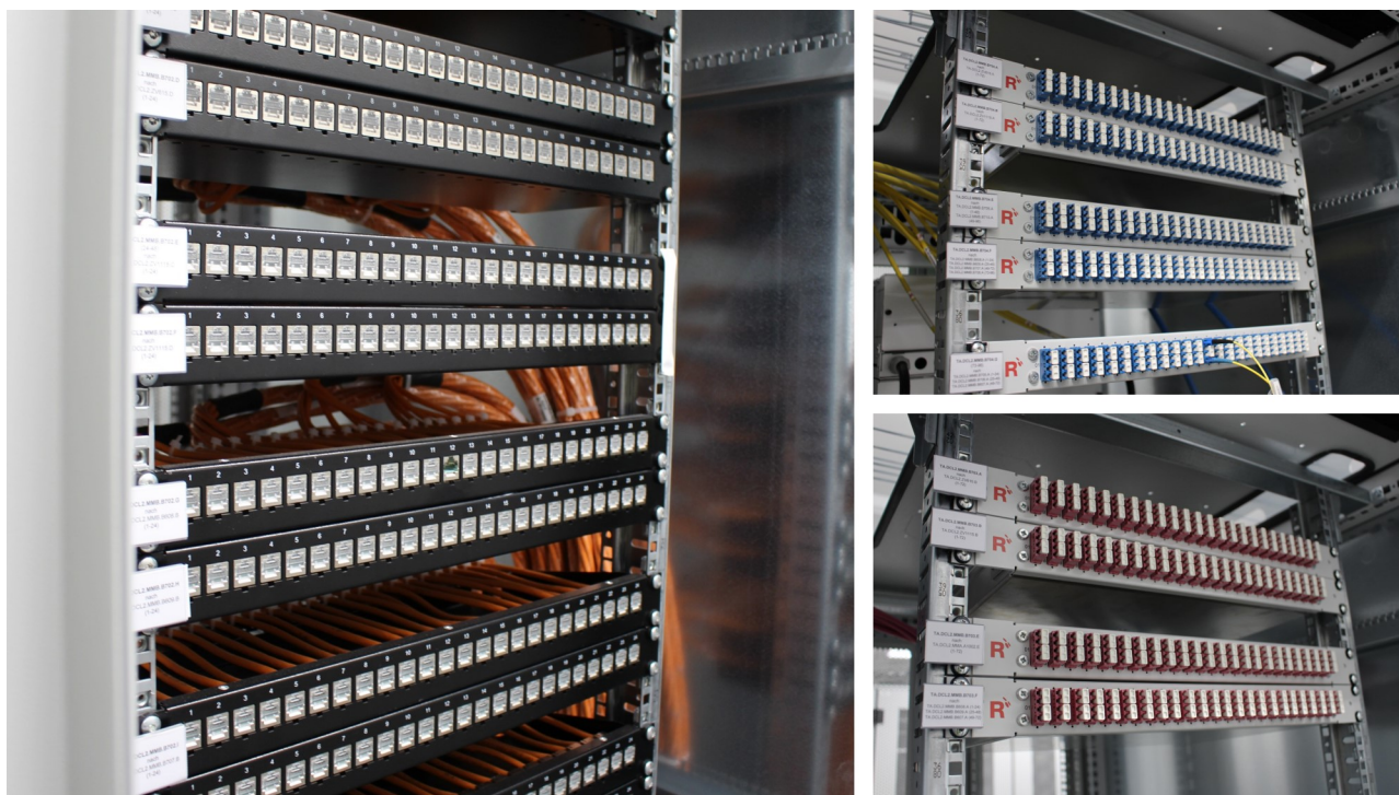
Vista nel nuovo datacenter di colocation
