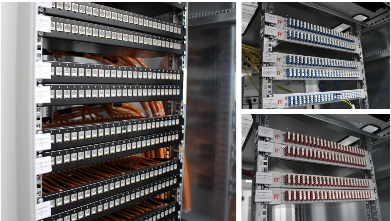
Vue dans le nouveau centre de données de colocation
